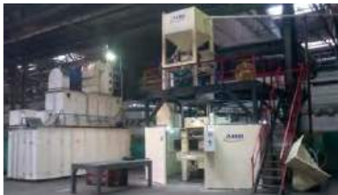
Рисунок 4 - Общий вид. АБХУ РУП «ГЗЛиН» РБ. АБХУ очистки вентиляционного воздуха от триэтиламина. Производительность по вентвоздуху 10 000 м 3 /ч
