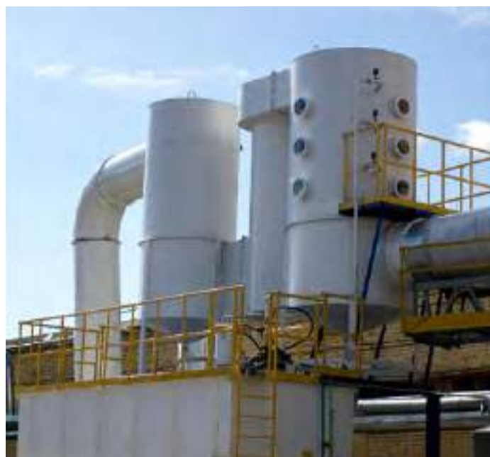
Рисунок 2 - Общий вид АБХУ. ЗАО «Красный якорь» РФ. АБХУ очистки вентиляционного воздуха от фенола, формальдегида. Производительность по вентвоздуху 30 000 м 3 /ч
