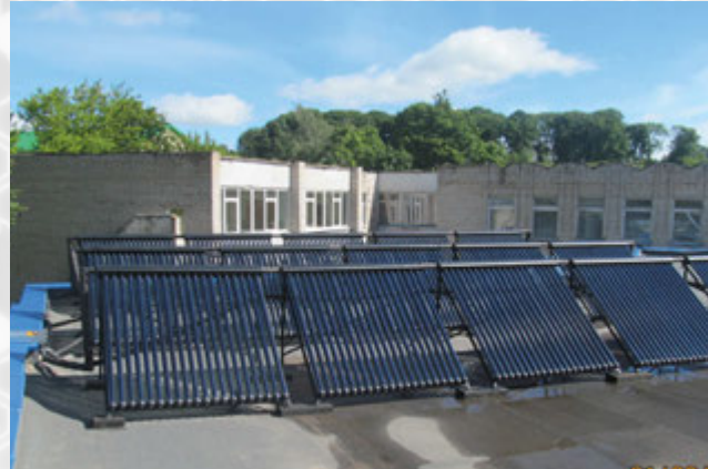
Солнечный коллектор для нагрева воды для бассейна в Новогрудском детском саду №10
